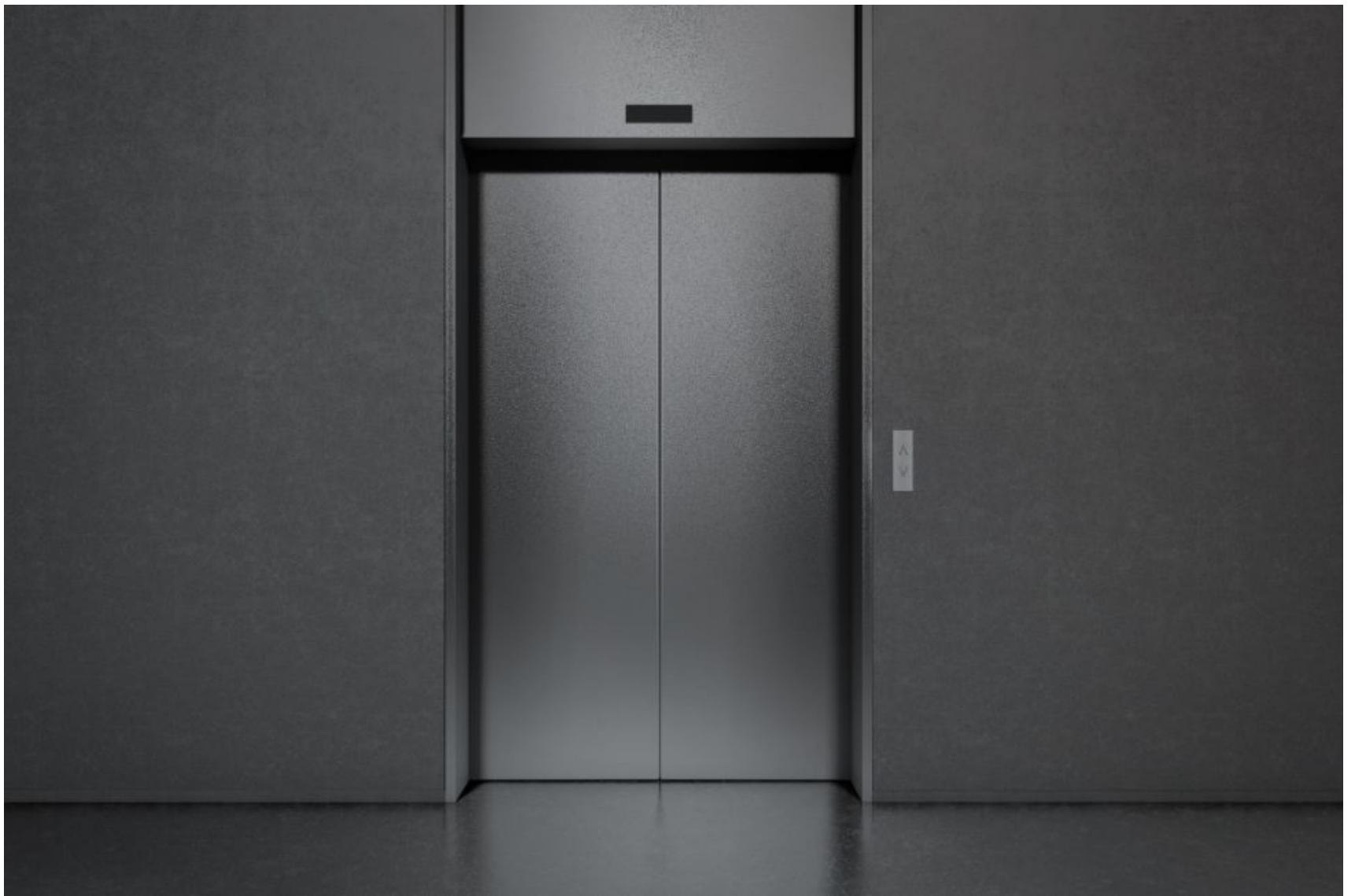
Aufzug Souterrain bis Dachgeschoss
